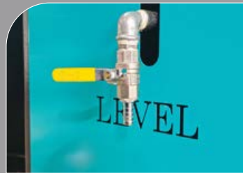
12 شیر تنظیم سطح آب مخزن Water Tank Level Valve
